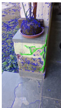
Figura 1 – Análise de fissuras
