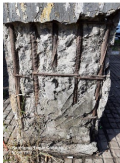
Figura 3: Pilar com armadura exposta
