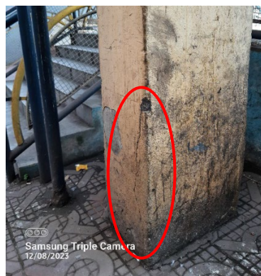
Figura 5: Pilar com Trinca
