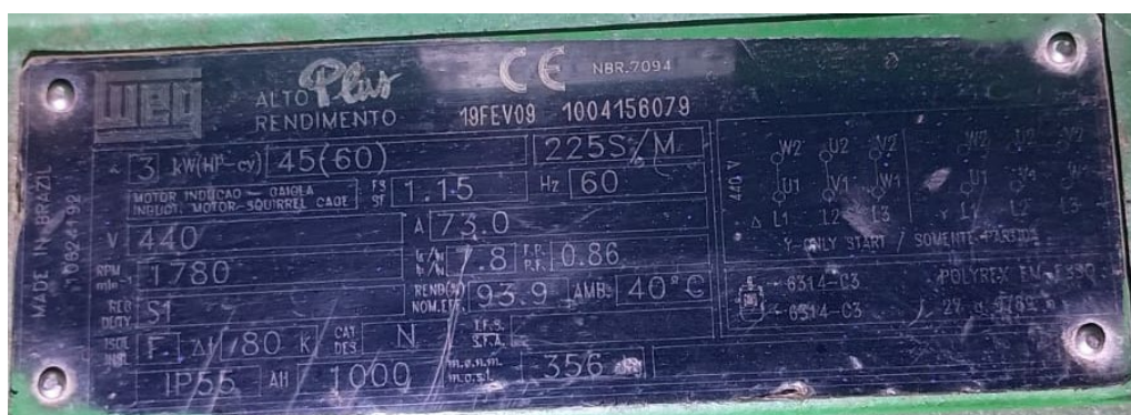
Figura 6: Placa de identificação do motor da prática
